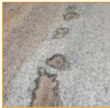
La imagen habla por sí sola. La baja calidad de la red de caminos estatales recién terminada.
