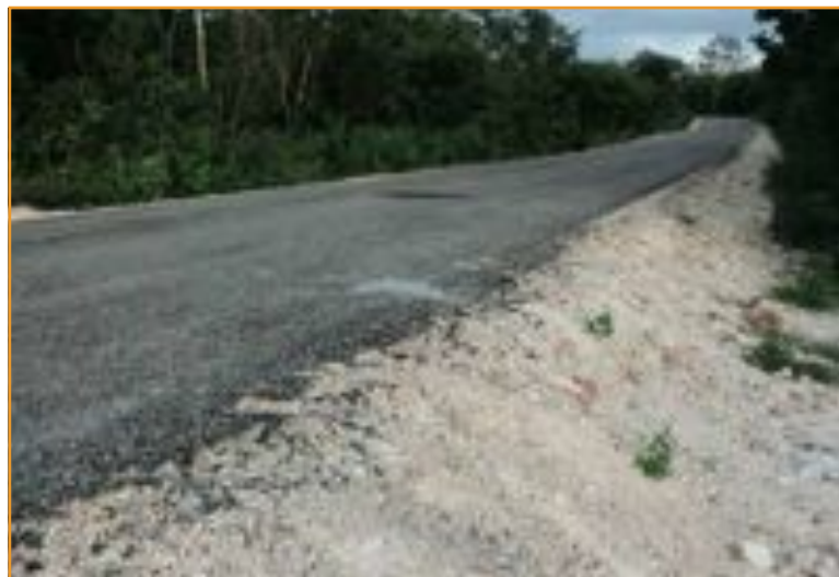
Reconstrucción del camino Unidad Productiva KANCABTUK de Muna. Una de las carreteras de la red estatal construidas este año por el gobierno del estado. Se observa en toda su longitud la delgadísima capa de asfalto.
