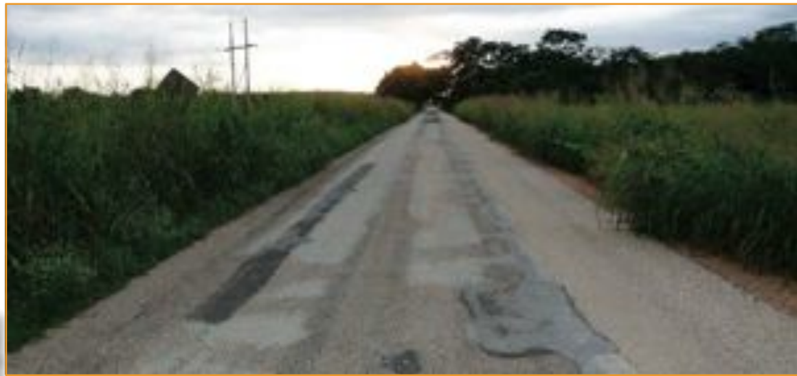
Nótese cómo todo el cuerpo derecho del camino "terminado" en el municipio de Muna carece de pavimento. Calidad "total", que avalan los empresarios de la construcción en su despliegado.
